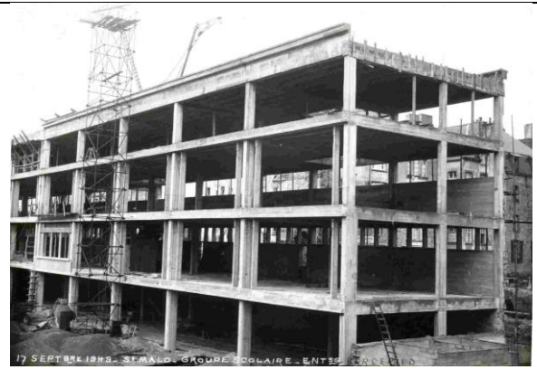
Cette photo présente le groupe scolaire en cours de construction. Le principe de l'ossature béton est clairement visible. Un élément de façade a été apposé à gauche.
