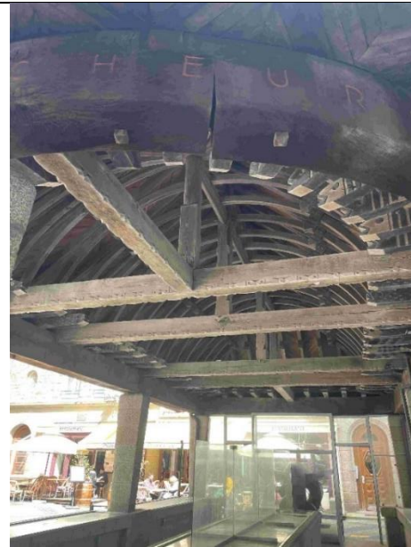
Figure 61 Marché aux poissons, détail de la charpente, place de la poissonnerie, Saint-Malo, Henry Auffret, 1954 © DJ 22/04/2024
